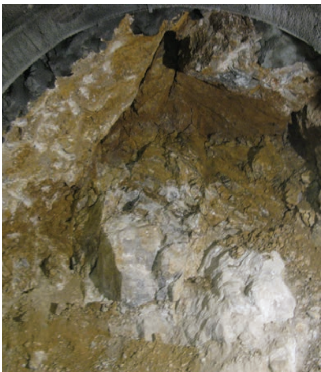
شکل ۱۳: خطر سقوط سنگ در تونل
